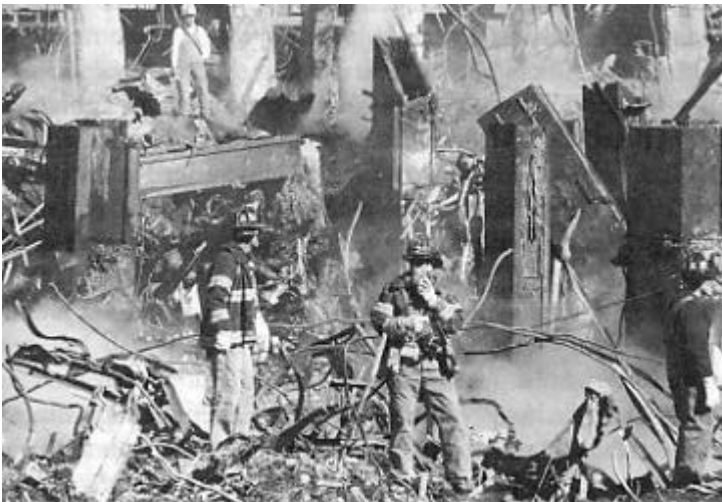
Der Kernstahlträger in der Mitte scheint durch Schweißbrenner getrennt zu sein. Die Arbeit ging so schnell vonstatten, daß die Feststellung der Schadensursache schwerfällt.
