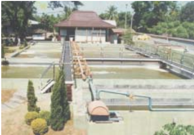
Unit pengolahan limbah dengan Sistem Aerasi Lanjut (SAL)
